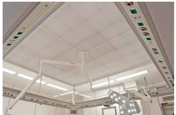
TAV-Decke mit umlaufender Medienbrücke/ Laminar air flow ceiling with circumferential media bridge
